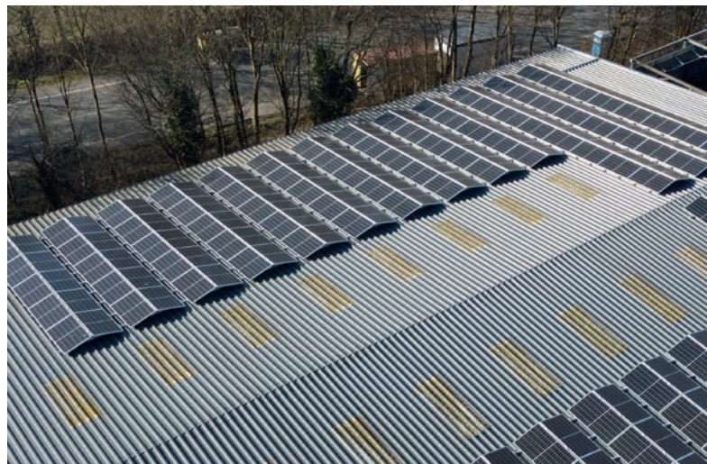
Photovoltaik: Dachflächen sinnvoll genutzt
